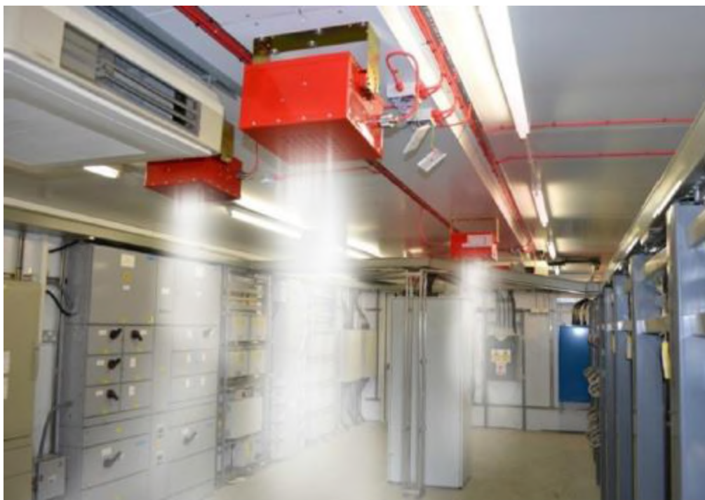
Рисунок 6 – Газовая система пожаротушения на складе
