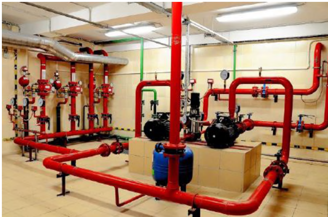
Рисунок 1 – Установка автоматизированной системы пожаротушения
