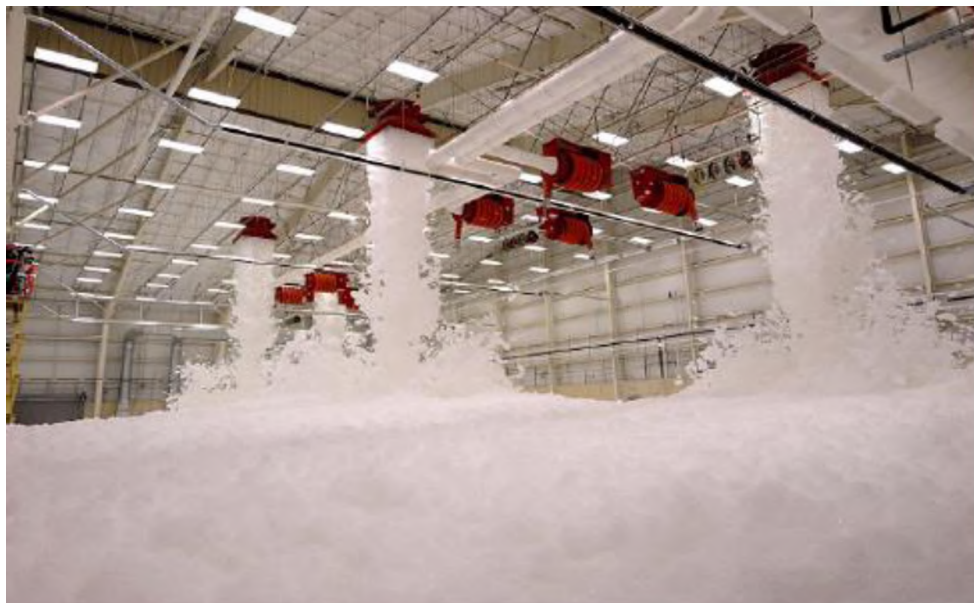
Рисунок 5 – Пенная система пожаротушения на складе
