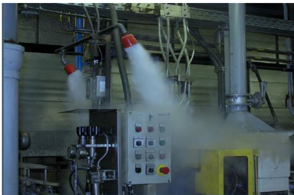
Рисунок 4 – Аэрозольная система пожаротушения на складе
